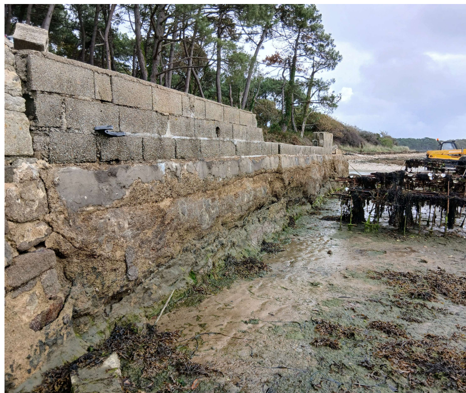
Mur effondré de l'ancien bassin insubmersible vu de l'estan
