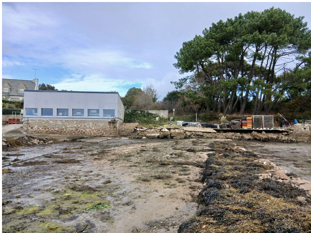
Mur soutènement effondré coté mer
