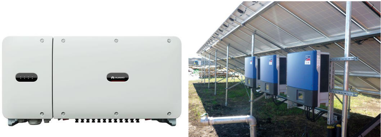
Photo 3 : Exemple d'onduleurs photovoltaïques et installation à l'arrière des structures (Source : EneR Centre-Val de Loire)
