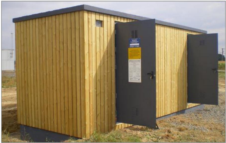
Photo 2 : Exemple de poste de livraison avec bardage bois (Source : EneR Centre-Val de Loire)
