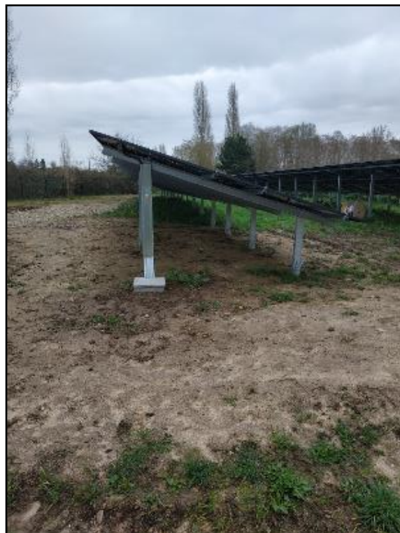
Figure 23 : Tables photovoltaïques avec structures en micropieux - Parc solaire de Soucelles - 299 kWc
