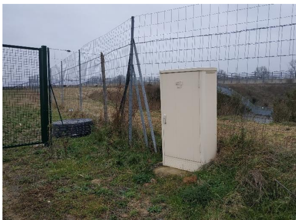
Figure 27 : poste de livraison de la Tranche 1, site de Louvigné
