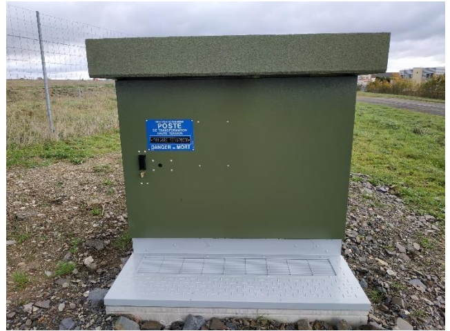
Figure 31 : poste de transformation « SOLAIRE » de Louvigné
