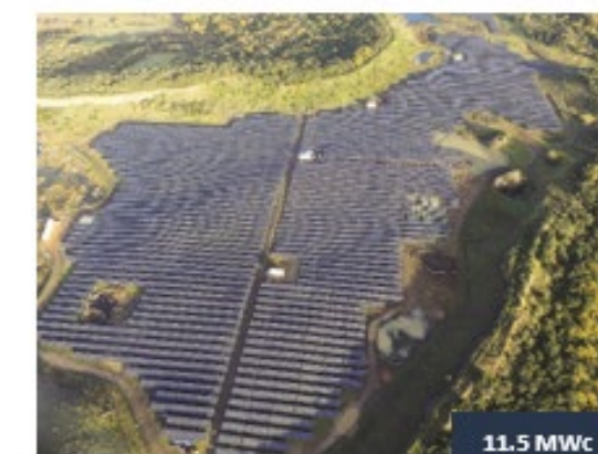
Parc solaire Nizas & Léznigan la Cèbe (34) – Foncier communal Développement, Financement, Construction et Exploitation Ancienne carrière
