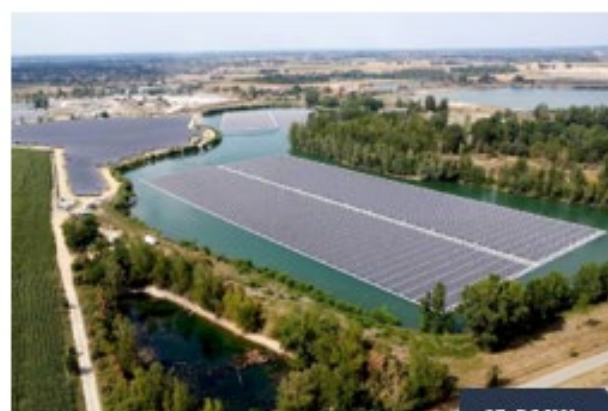
Parc solaire flottant - terrestre Salles-sur-Garonne (31) Développement, Financement, Construction et Exploitation Ancienne carrière
