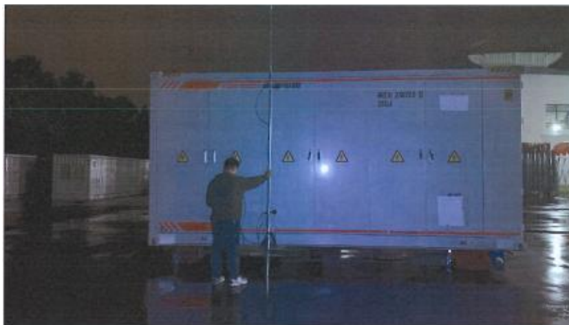
Photo extraite du rapport « 60kW 314Ah 10racks Sinobrook Energy Storage Thermal Management WNTR24049-4 Bare Chiller 2024.11.17.pdf »
