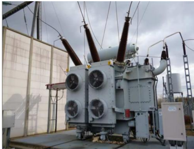
Exemple de transformateur (vue de dos)
