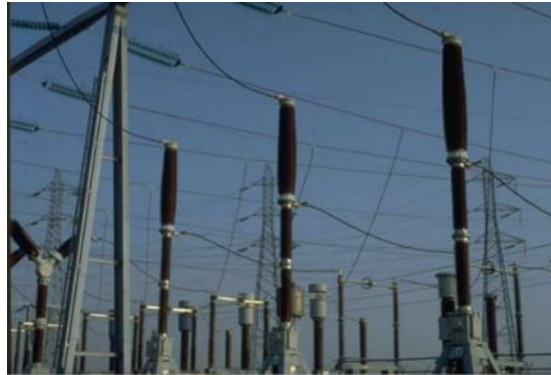
Exemple de disjoncteur
