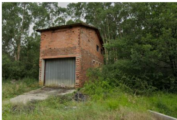
Bâti abandonnée situé à quelques mètres de la zone d'étude Issel, 2024
