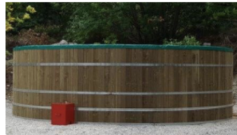
Figure 1717 : exemple d'une citerne incendie bardée bois
