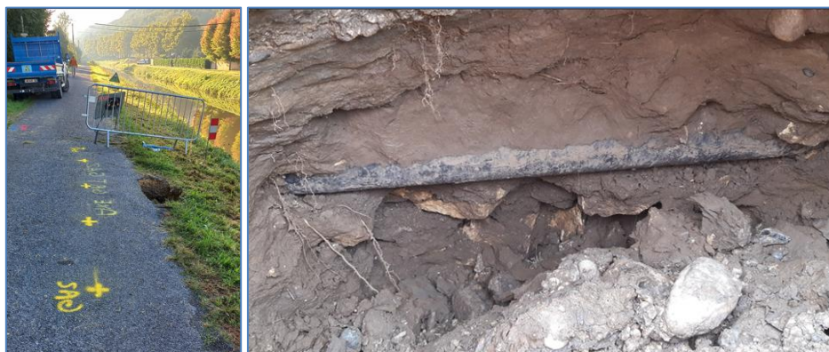
Exemple d'effondrement constaté régulièrement
