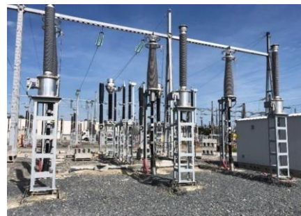
Une cellule 400 000 volts © RTE
