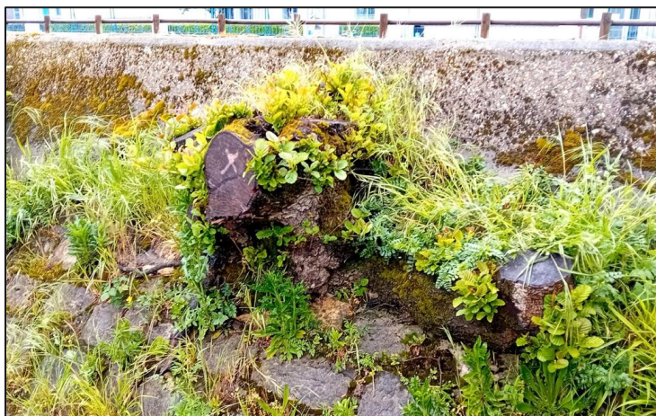
Figure 28: Racines et souches dans les joints de perré, entre le perré et le muret
