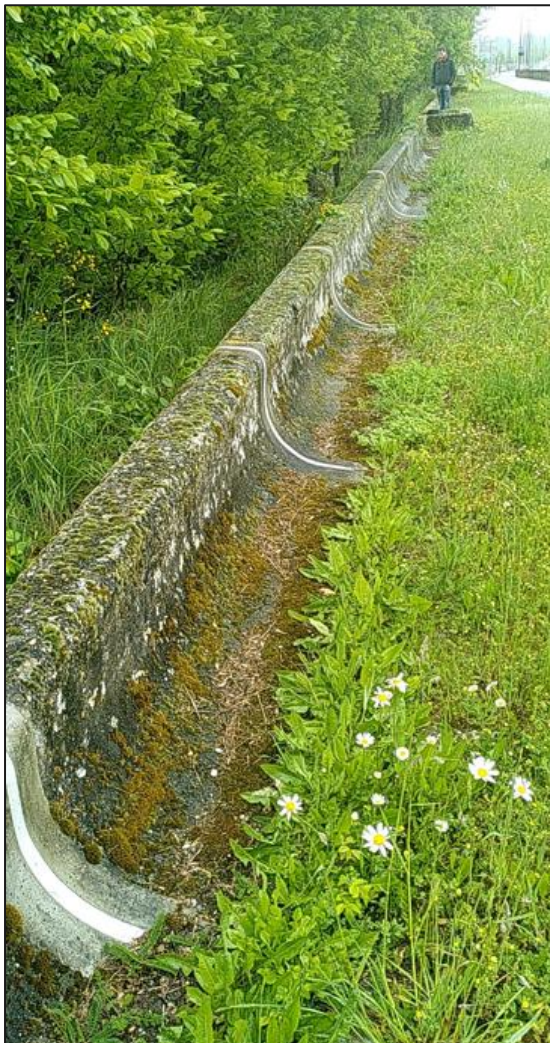
Figure 26 : Fissures espacées de l'ordre de 3 m en bon état
