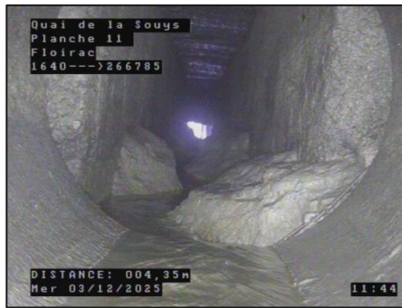
Dépôt à priori argileux - obstruant
