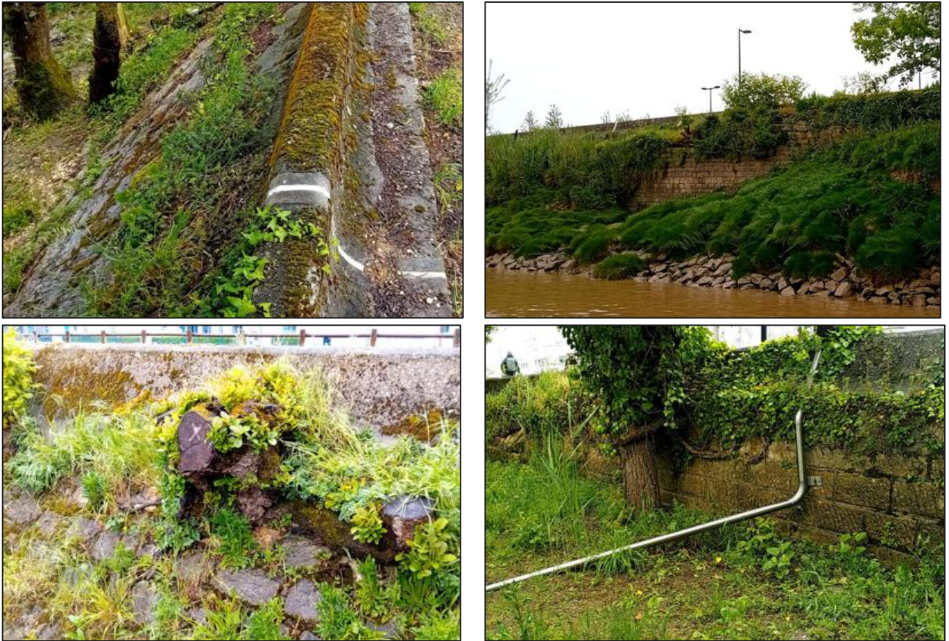
Figure 8 : Présence et état du perré en moellons de 1822
