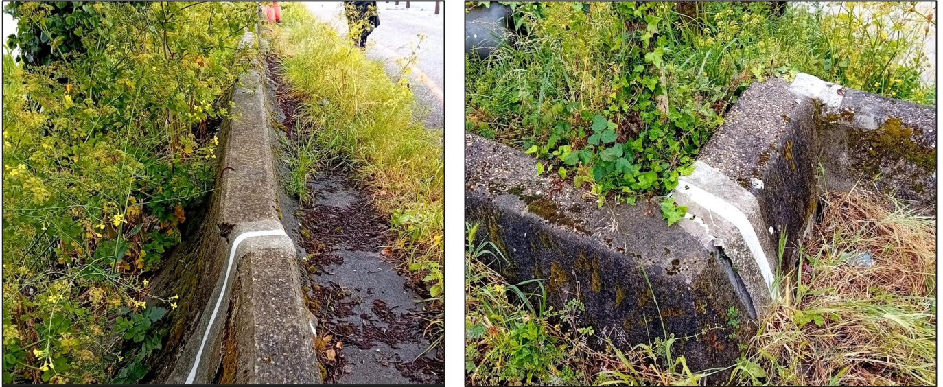
Figure 13 : Etat des réparations 2018 – Photos d'avril 2025
