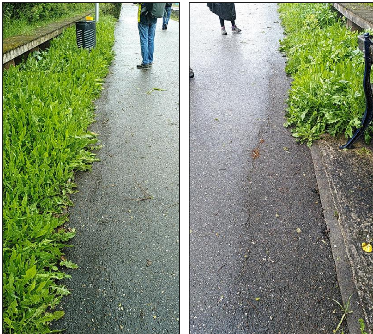
Figure 30 : Exemple de désordres visibles sur le bitume
