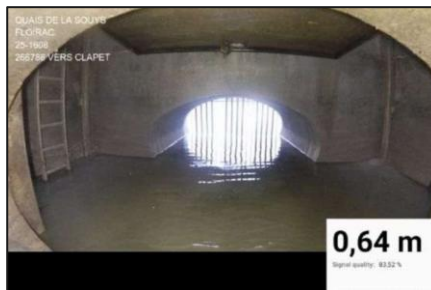
Regard arrivée sur grille, bon état
