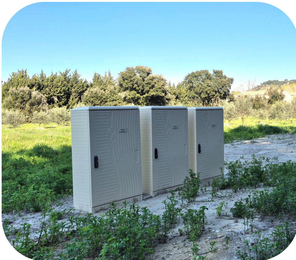
Figure 22 : Exemple d'armoires Enedis - Source : Melvan
