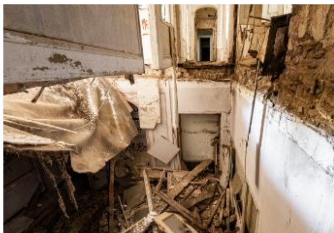
Photo 19 : partie du couloir du 1er étage du château du XIXe écroulé en 2023
