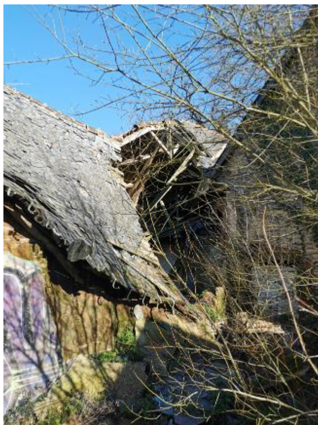
Photo 21 : bâtiment annexe du XVIIe (façade et plancher intérieur tombés en 2025 ; P Péron – février 2026)
