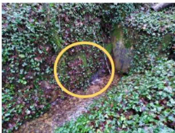
Photo 4 : fuite au niveau de l'exutoire de la douve (ISL Ingénierie)
