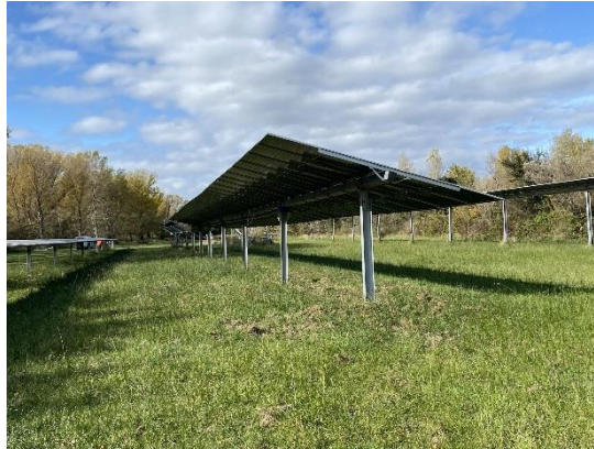
Figure 11 : Exemple de structure solaire agrivoltaïque – SDMD
