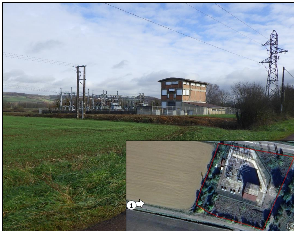
Figure 4 : Poste source existant – Prise de vue du 03 décembre 2024- ENEDIS
