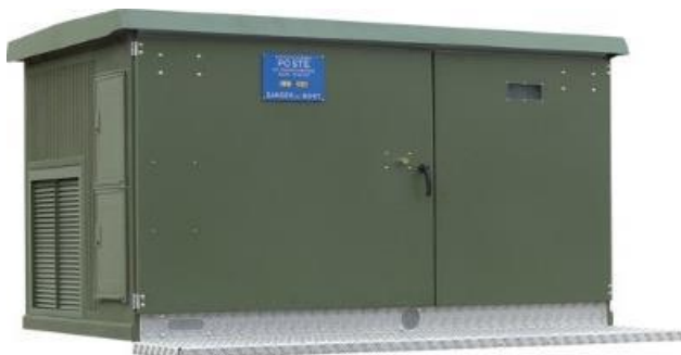
Figure 9. Exemple de poste de transformation
