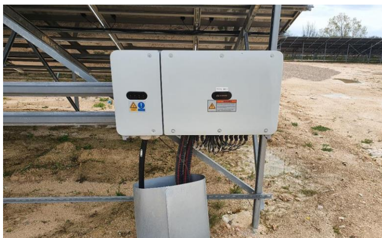
Figure 12. Exemple d'onduleur "décentralisé" positionné en bout de rangée
