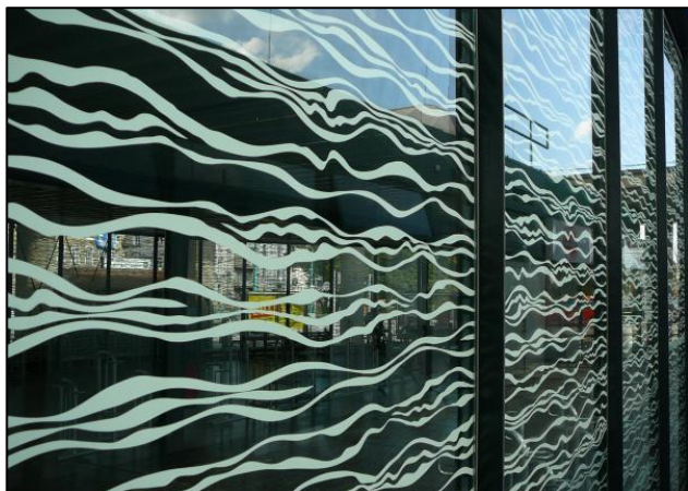
Exemple de systèmes anti-collision installés (motif efficace rendant le vitrage visible par les oiseaux)
