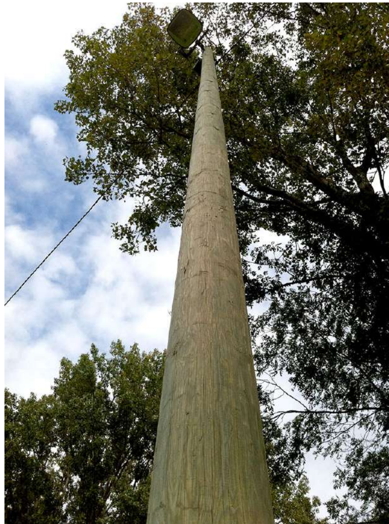
Poteau en bois classe IV avec lanterne d'éclairage
