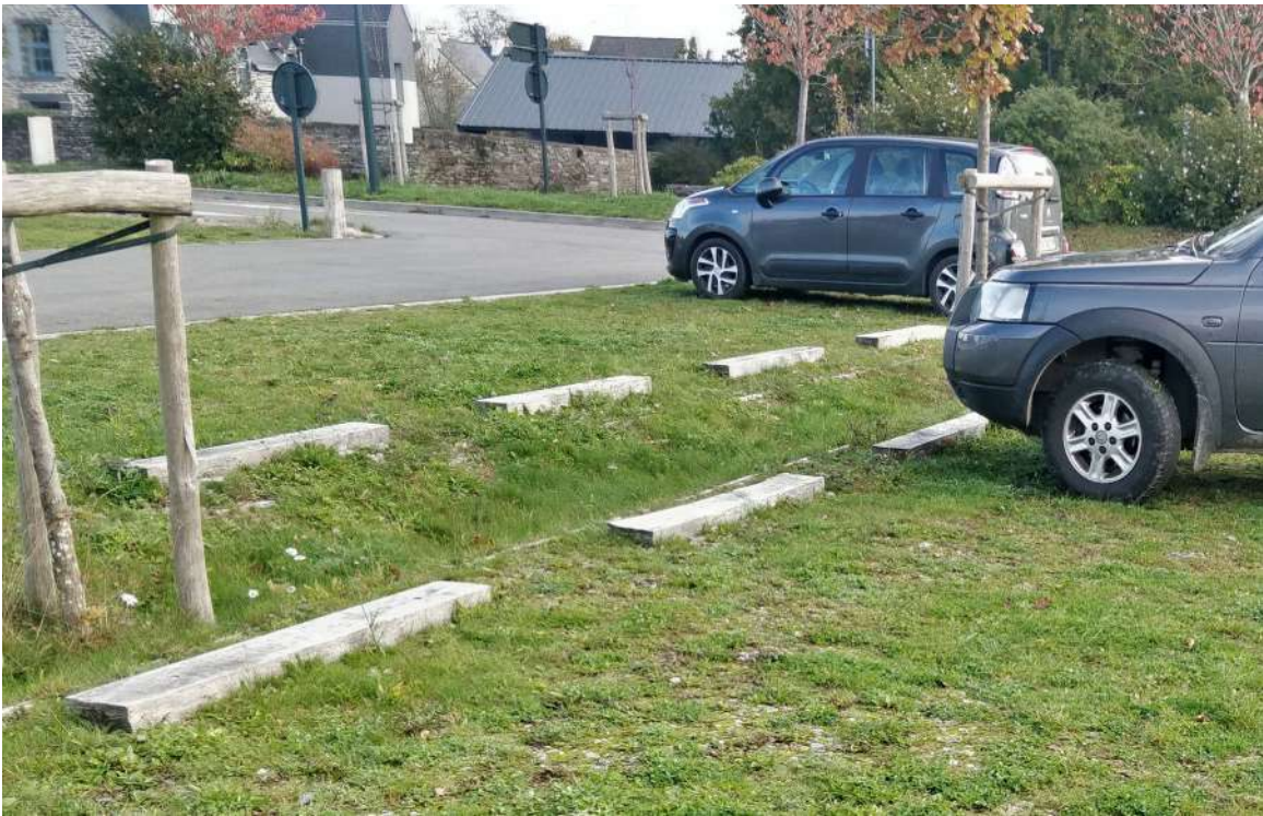
Photographie d'un exemple de noue engazonnées sur un parking en mélange terre-pierre.
