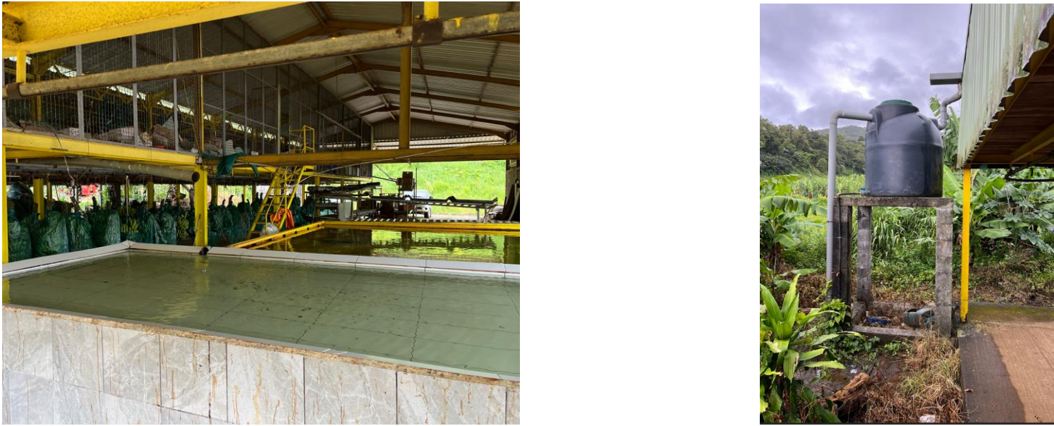
Figure 34 : Exemple de systèmes de récupération d'eau de pluie existants (hangar)
