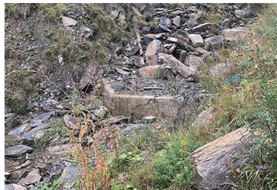
Captage de Prévache (alt. 1 532 m)
