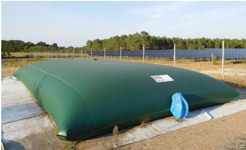
Figure 28 : Citerne incendie (source : maciternesouple.fr)
