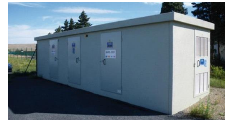
Photographie 6 : Poste de livraison (Source : ENCIS Environnement)
