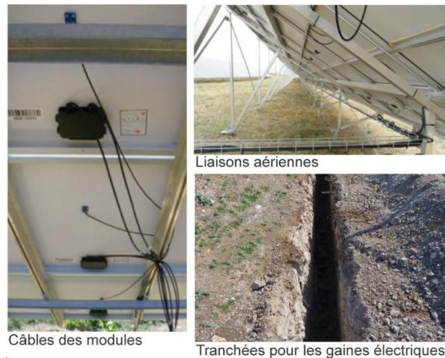
Photographie 7 : Liaisons électriques (Source : ENCIS Environnement)
