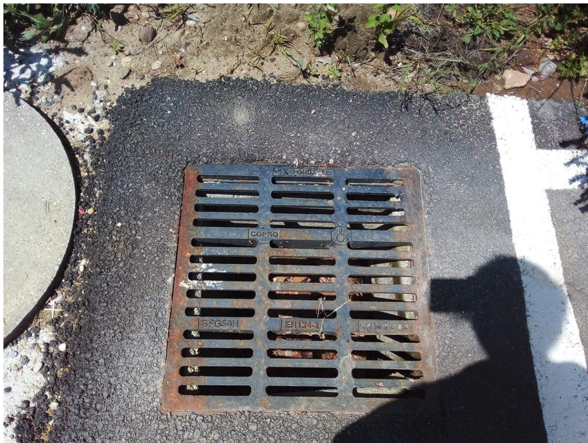
Figure 9 : Avaloir localisé au niveau du parking
