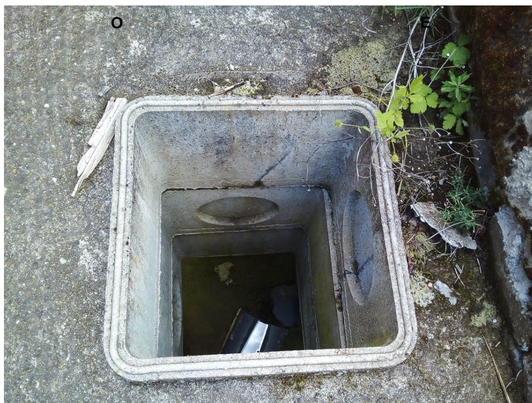
Figure 8 : Regard eaux pluviales (façade-arrière du château).
