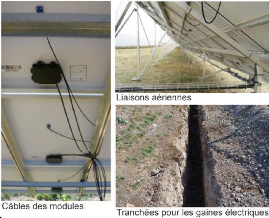
Photographie 6 Liaisons électriques (Source : ENCIS Environnement)
