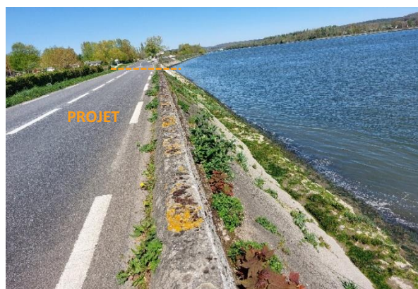
Figure 18 Vue n°8 Etat actuel de la digue : présence d'essences pionnières comme l'érable sycomore ou le Buddléia à travers les fissures du béton.
