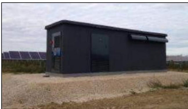
Figure 39 : Exemple de poste de transformation et de livraison
