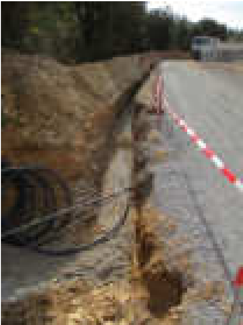
Figure 123 : Exemple de tranchée en bordure de piste (source : QENERGY, 2025)
