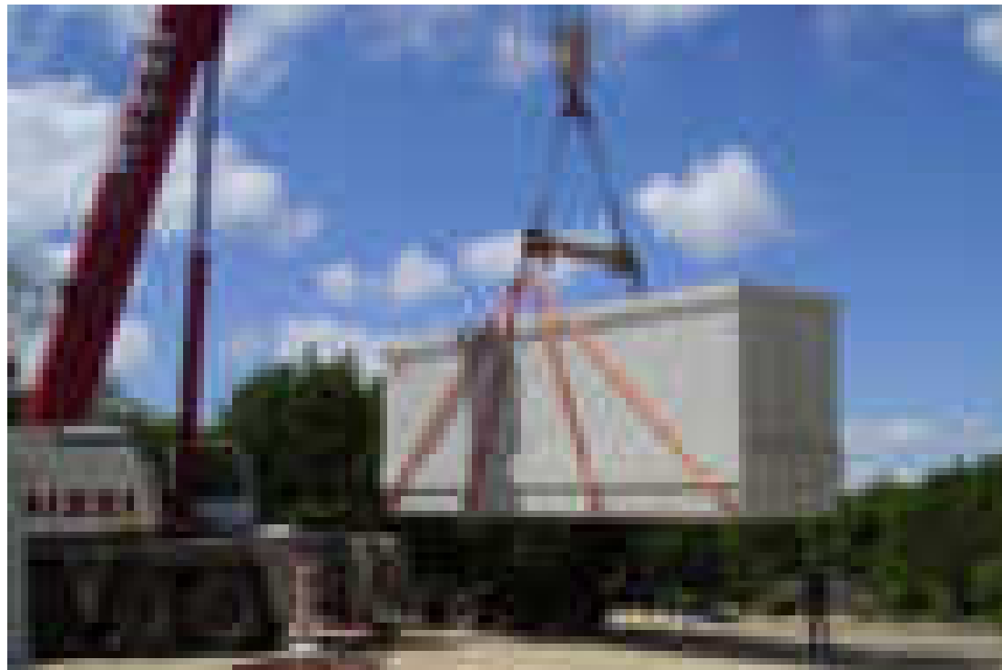
Figure 125 : Installation d'un poste électrique (source : QENERGY, 2025)
