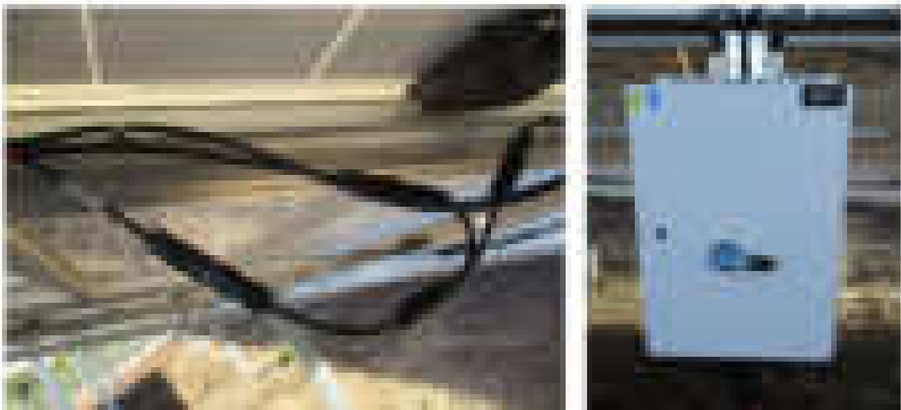
Figure 116 : Exemple de câble électrique et de boîte de raccordement (source : QENERGY, 2025)
