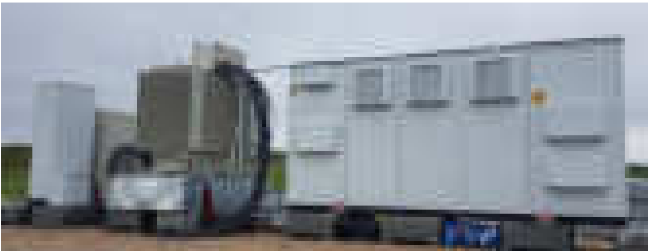
Figure 118 : Exemple d'onduleurs et transformateur installés à l'extérieur (source : QENERGY, 2025)
