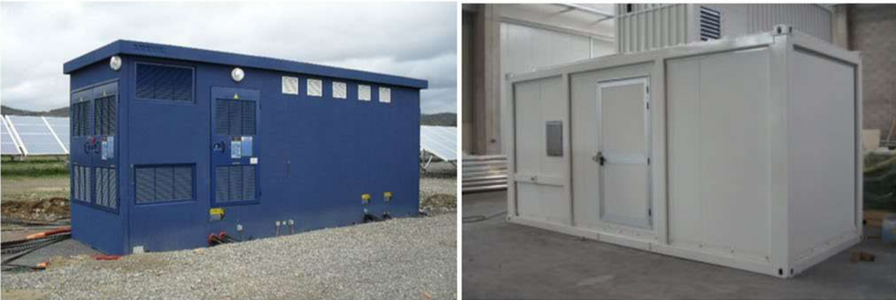
Figure 5 : Exemple d'onduleurs et transformateur installés dans des postes béton et containers (source : QENERGY, 2025)
