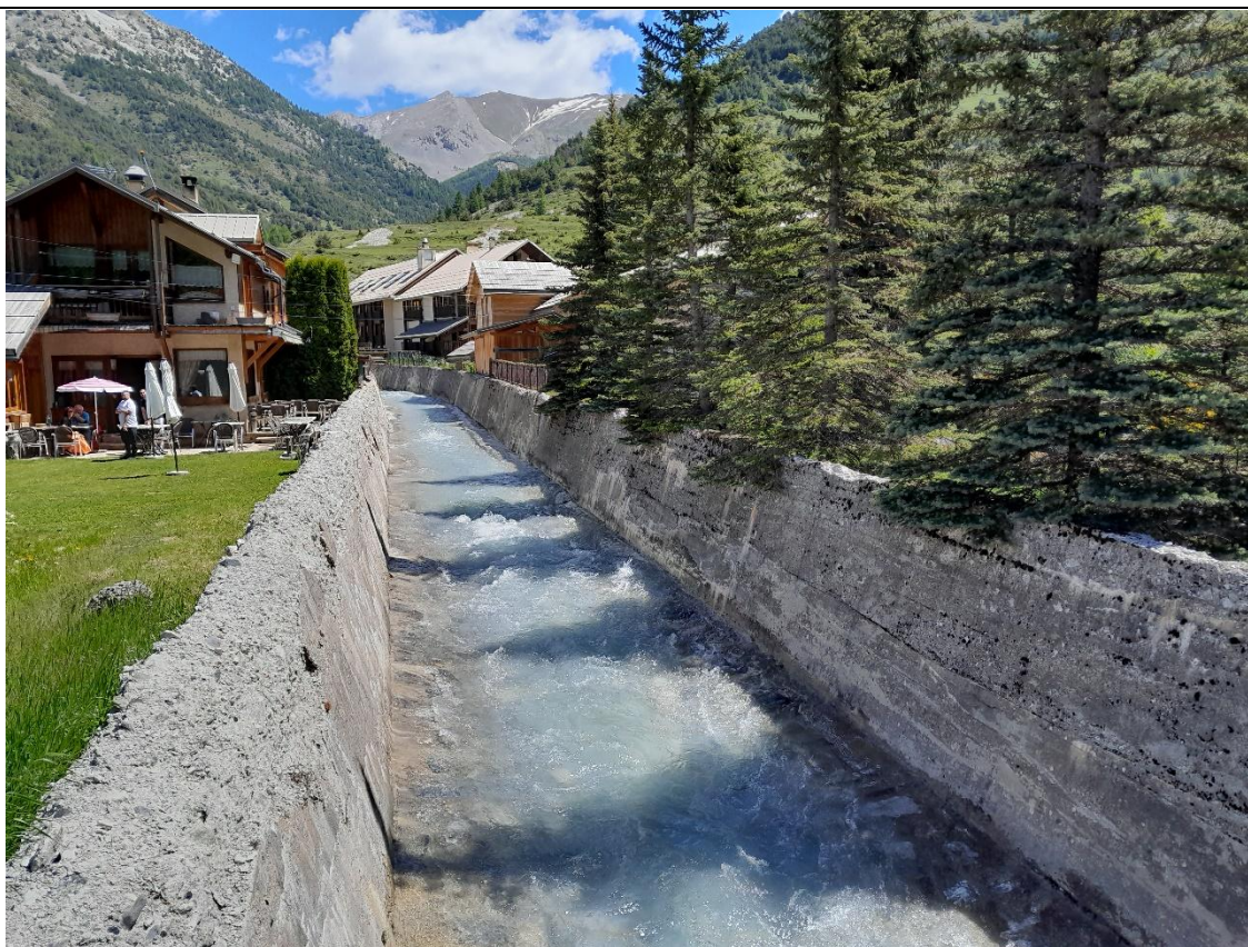
↑ Fig. 5 Chenal dans le bourg, vue vers l'amont. Etat des sommets de digues (rive droite)
