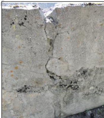
Figure 16 : Exemple de fissuration sur le parement (Source ONF-RTM, VTA 2015)
