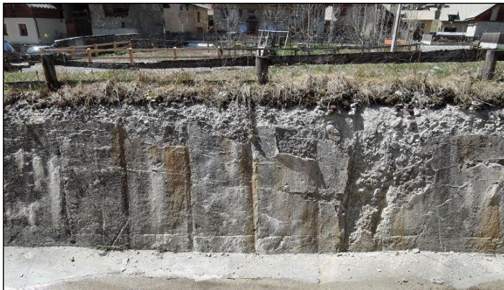
Figure 17 : Exemple d'altérations dans la masse du béton - tronçon 3 – RD (Source ONF-RTM, VTA 2015)
