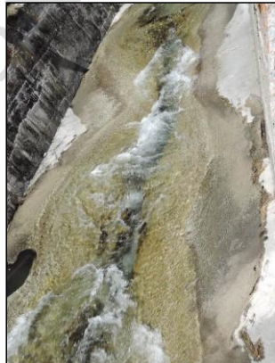
Figure 12: Exemple de dégradation du radier du chenal (Source ONF-RTM, VTA 2015)
