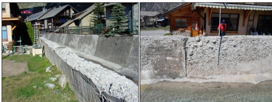
Figure 18 : Exemple d'altération du béton dans la masse (Source ONF RTM, VTA 2024)
