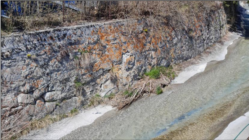
Figure 21 : Exemple de joints à reprendre sur les murs maçonnés
