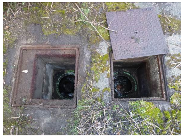
Figure 18 : Vue du séparateur d'hydrocarbures présent du côté Nord de l'aire de lavage
