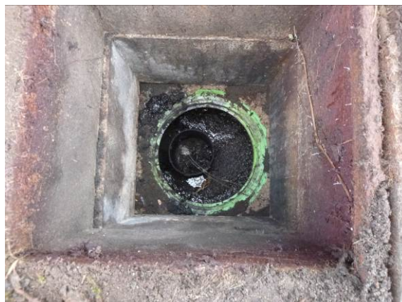
Figure 20 : Vue du compartiment aval du séparateur d'hydrocarbures
