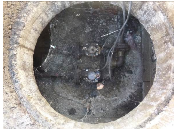
Figure 4 : Vue du regard de répartition des conduites de GO présent sur l'îlot central
