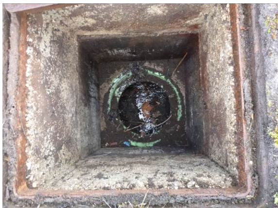
Figure 19 : Vue du compartiment amont du séparateur d'hydrocarbures
