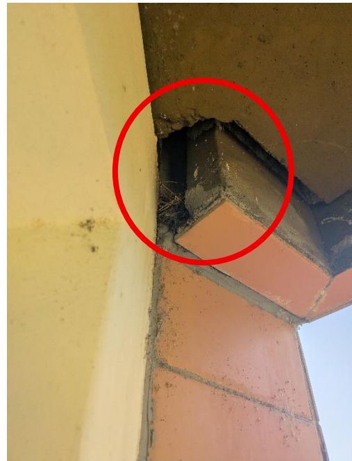
Figure 38 : Cavités profondes sous les balconnets
