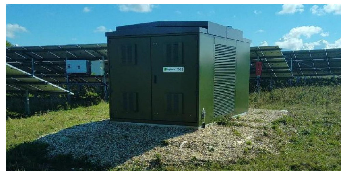
Photographie d'illustration d'un poste de transformation
