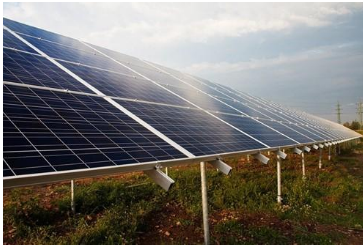
Illustration 4 : Panneaux photovoltaïques (Source : omeo.com)
