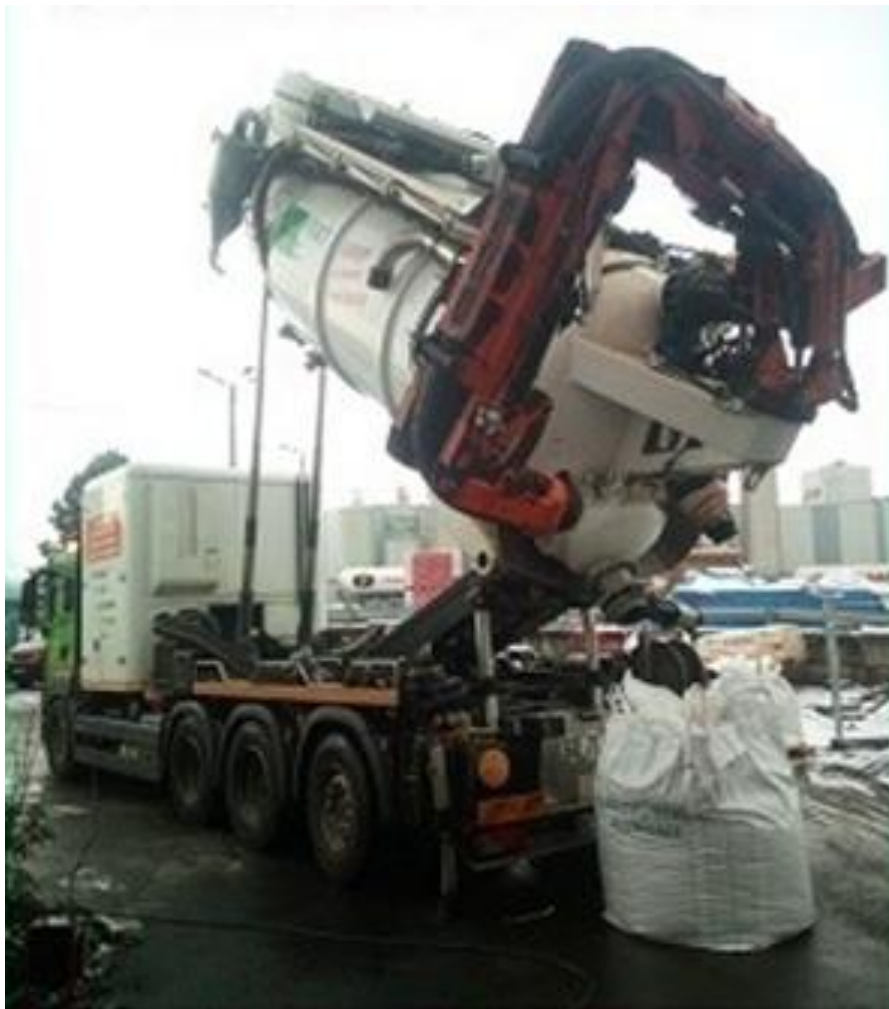
Figure 22 : Visuel de remplissage d'un big-bag par un camion hydrocureur
