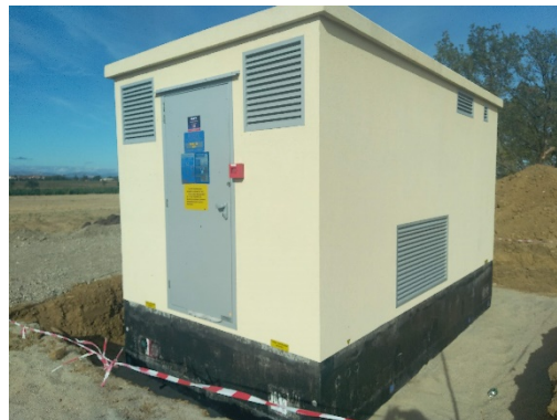
■ Figure 3 : Illustrations d'un poste de transformation
