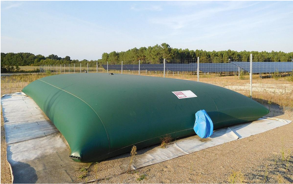
Figure 19 : Photo d'une bâche incendie
