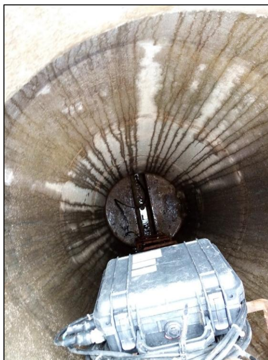
Photo 6 : Débitmètre Doppler mis en place dans la canalisation aval déversé du PR Entrée STEU
