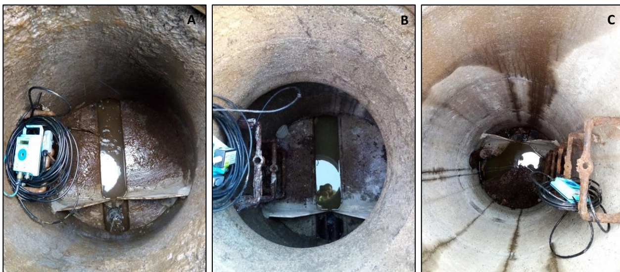
Photo 4 : Point de mesures gravitaire avec seuil en V au niveau des regards R78 (A) et R125 (B) et R153 (C)
