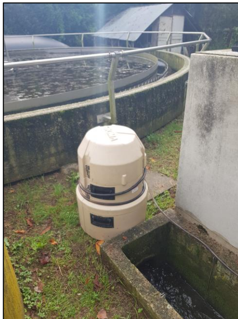
Photo 8 : Préleveur installé en sortie de la STEU
