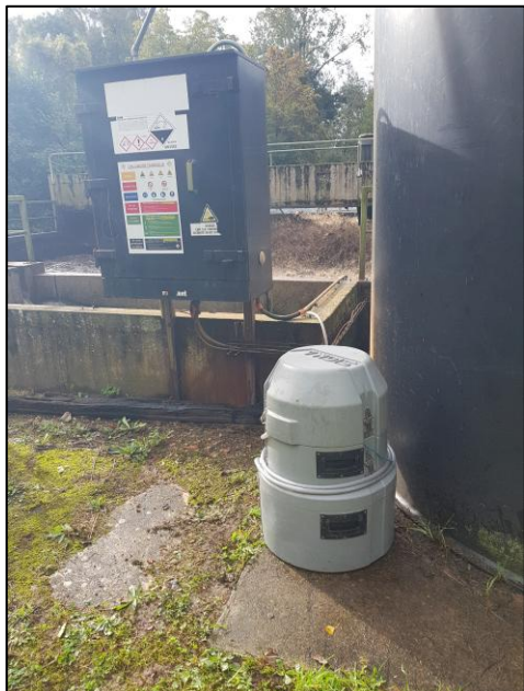
Photo 7 : Préleveur installé en entrée de la STEU
