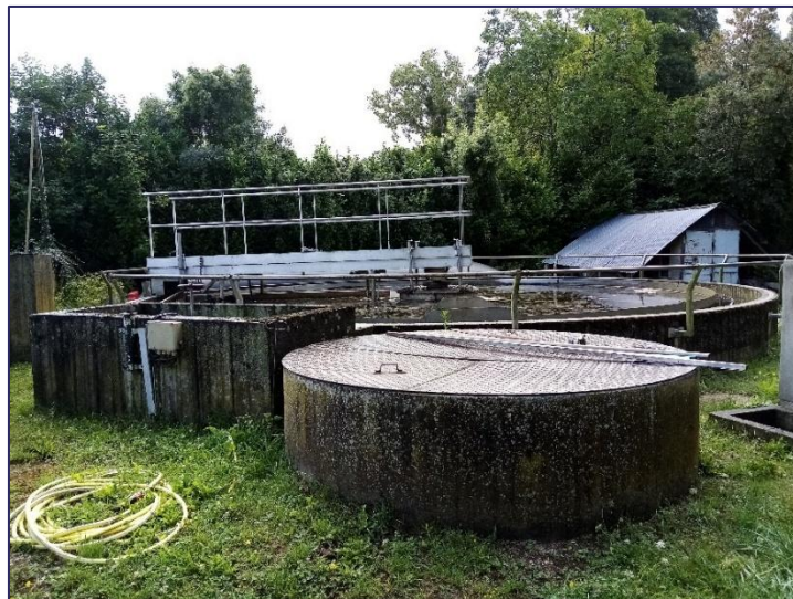
Photo 2 : Station de traitement de Preuilly-sur-Claise
