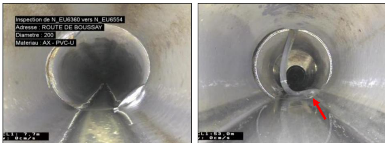
Photo 6 : Joints d'étanchéités pénétrants sur deux assemblages de collecteurs entre les regards N_EU6360 > N_EU6554 avec une infiltration par écoulement continu (à droite)
