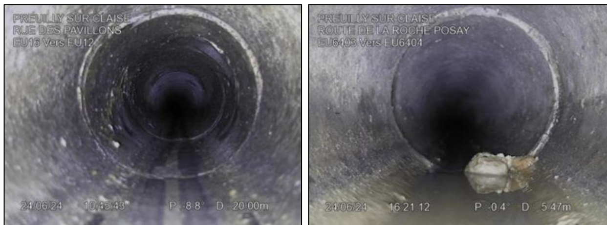
Photo 5 : Décentrage radial recensé sur des tronçons entre les regards N_EU6505 > N_EU6506 (à gauche) et entre les regards N_EU6403 > N_EU6404 (à droite)
