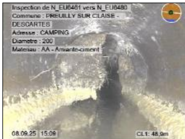
Photo 7 : Ensemble complexe de racines avec réduction de la section de 70% sur le tronçon N_EU6461 > N_EU6480
