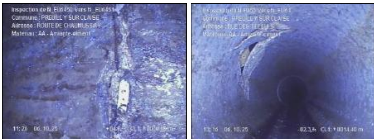
Photo 10 : Épaufrure sur le tronçon N_EU6450 > N_EU6451 (à gauche) et perforation sur le tronçon N_EU53 > N_EU54 (à droite)
