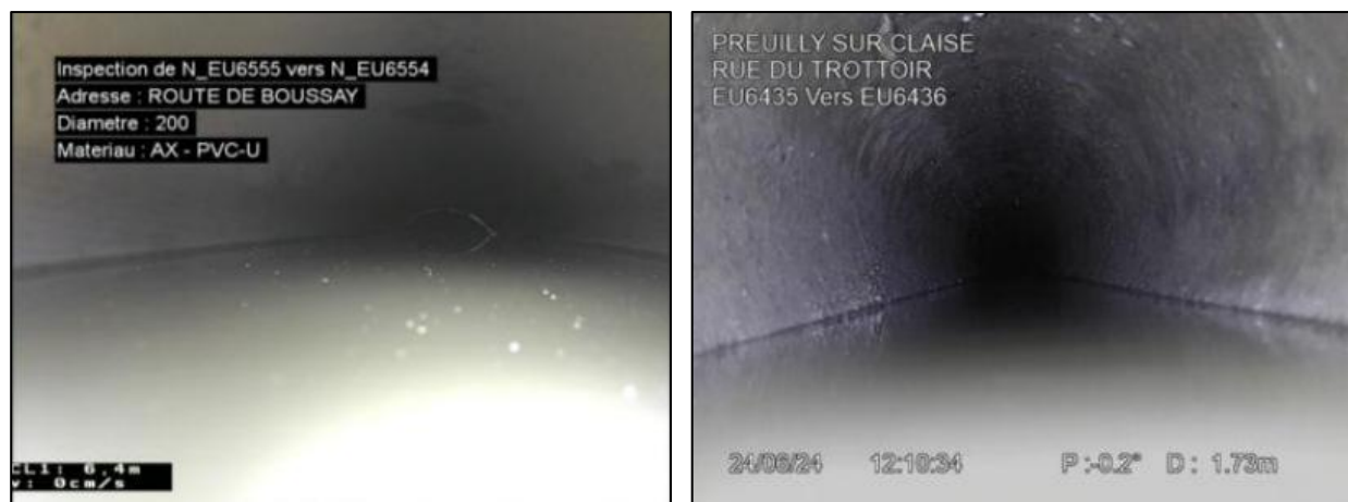
Photo 2 : Flèche de 80% sur les tronçons situés entre les regards N_EU6555 > N_EU6554 (à gauche) et flèche de 20% sur les tronçons situés entre les regards N_EU6435 > N_EU6436 (à droite)
