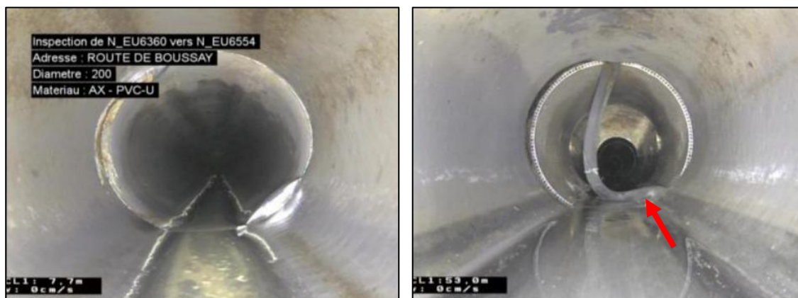
Figure 35 : Joints d'étanchéités pénétrants sur deux assemblages de collecteurs entre les regards N_EU6360 > N_EU6554 avec une infiltration par écoulement continu (à droite)
