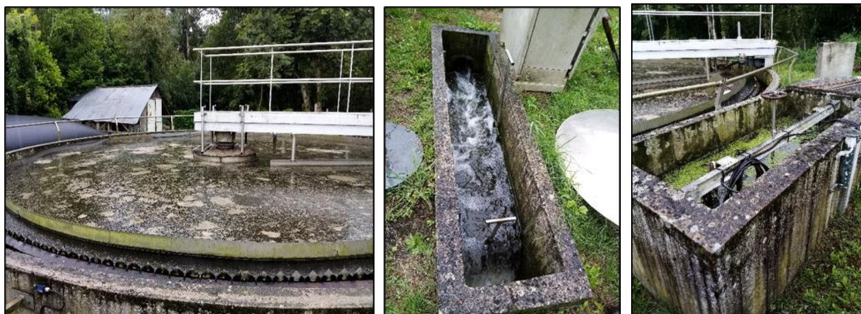
Figure 27 : Photographies de la station de traitement de Route de Chaumussay
