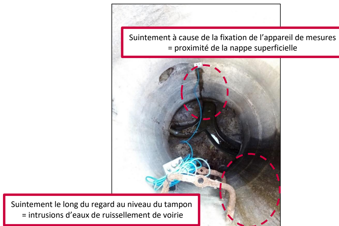
Figure 39 : Défaits d'étanchéité du regard du TP PR Collège
