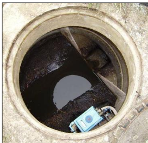
Photo 12 : Exemple de mise en place d'une sonde de niveau et de son enregistreur couplé à un seuil triangulaire
