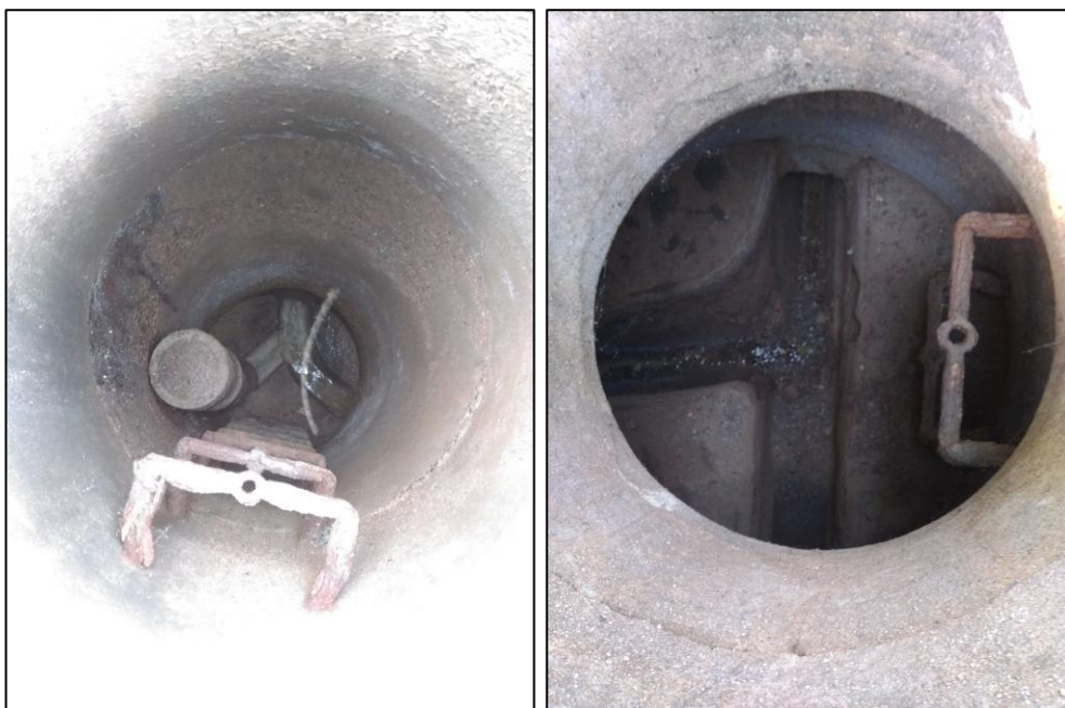
Photo 9 : Présence de corrosion sur les tampons des regards N°2 et N°21
