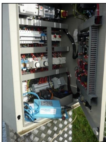
Photo 11 : Armoire électrique équipée de pincés ampérométriques
