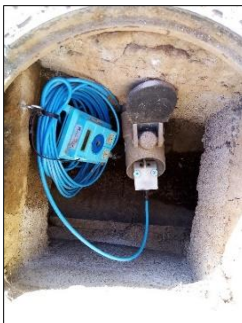
Photo 13 : Exemple de détecteur de surverse dans un trop-plein
