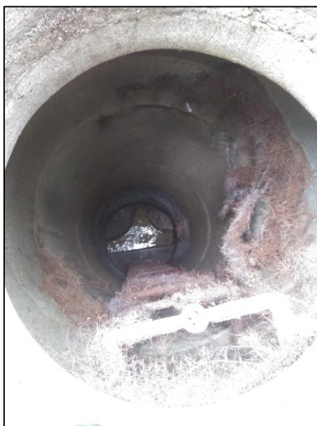
Photo 10: Présence de racines sur les tampons du regard N°1
