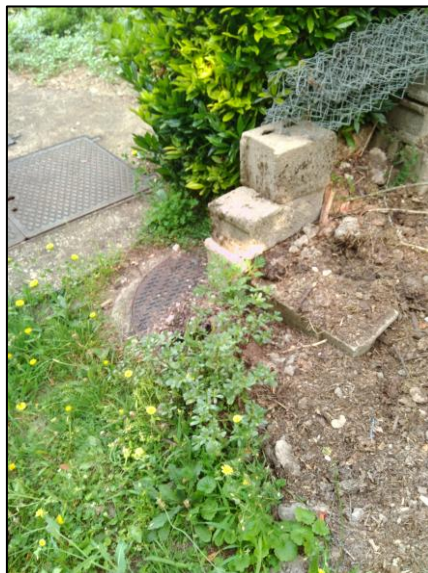
Photo 7 : Regard eaux usées N°8
