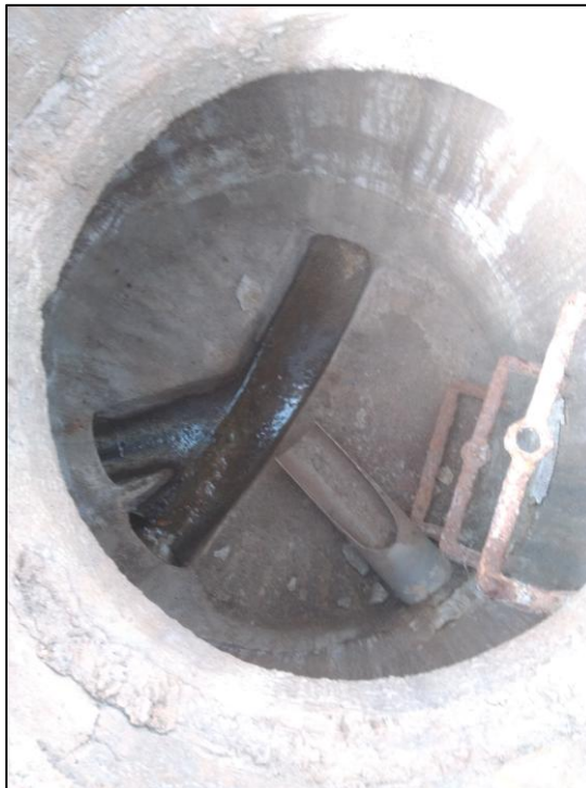
Photo 8 : Présence de dépôt dans les regards
