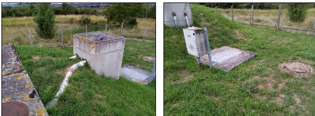
Figure 31 : Station de traitement du Grignon
