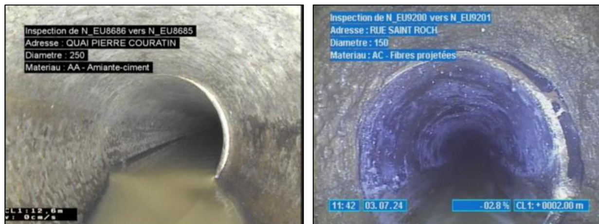
Figure 5 : Déviation angulaire sur les tronçons situés entre les regards N_EU8686 > N_EU8684 (à gauche) et décentrage radial lors d'un changement de matériau entre les regards N_EU8741 > N_EU8683 (à droite)
