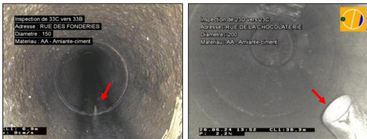
Figure 15 : Infiltration en continu sur un tronçon de branchement entre les regards N_EU33C > N_EU33B, et écoulement d'eaux claires en provenance d'un branchement sur le regard N_EU23C.
