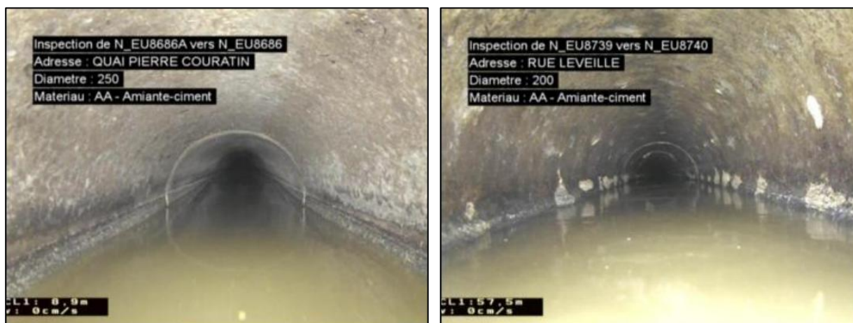
Figure 10 : Flèche de 50% sur les tronçons situés entre les regards N_EU8686A > N_EU8686 (à gauche) et flèche de 40% sur les tronçons situés entre les regards N_EU8739A > N_EU8740 (à droite)
