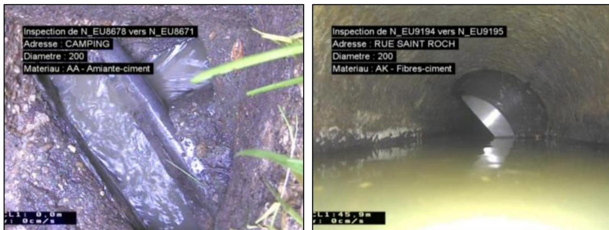
Figure 12 : Conduites externes insérées dans la canalisation au regard N_EU8678 (à gauche) et branchement pénétrant dans la canalisation entre les regards N_EU9194 > N_EU9195 (à droite)
