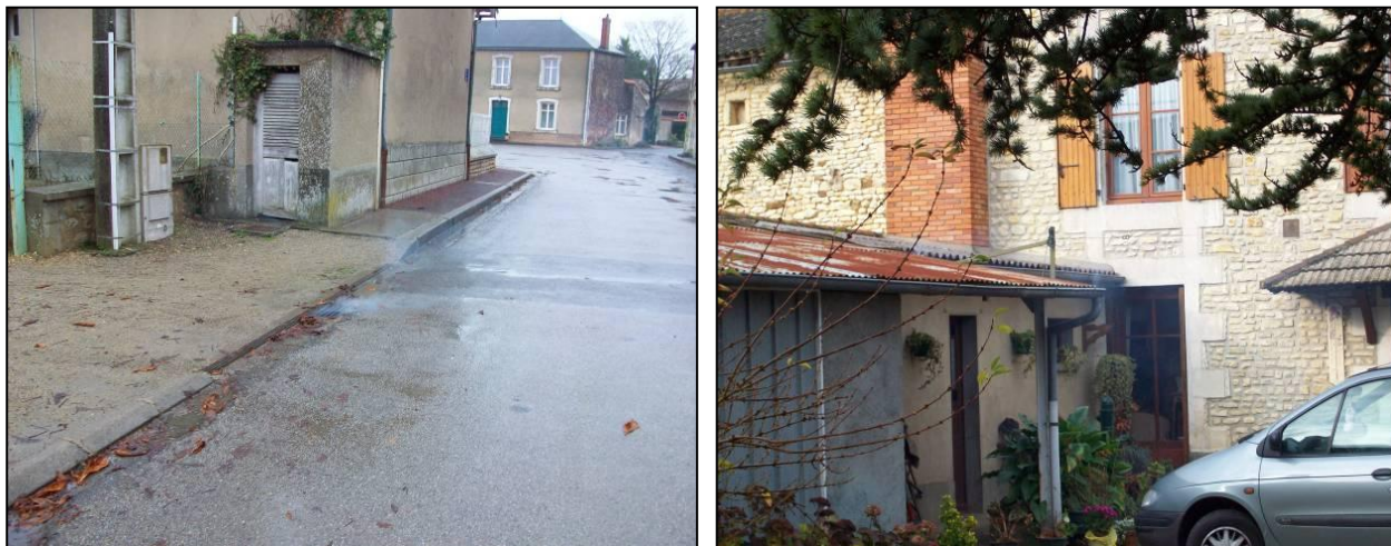
Figure 19 : Exemple de dysfonctionnements observés lors de tests fumigènes
