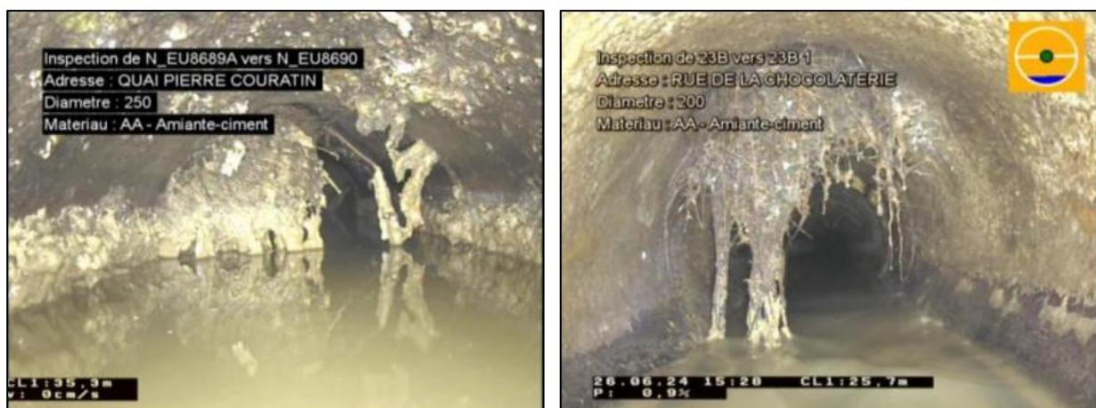
Figure 8 : Pénétrations de racines sur un assemblage de tronçons situés entre les regards N_EU8689A > N_EU8690 (à gauche) et au niveau d'un raccordement de branchement entre les regards N_EU33A > N_EU34 (à droite)
