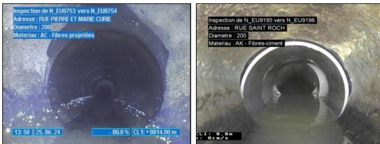
Figure 13 : Réparation d'un effondrement entre les regards N_EU9192 > N_EU9193 (à gauche) et décentrage radial avec changement de matériau ponctuel sur un raccordement de branchement entre les regards N_EU9195 > N_EU9196 (à droite)
