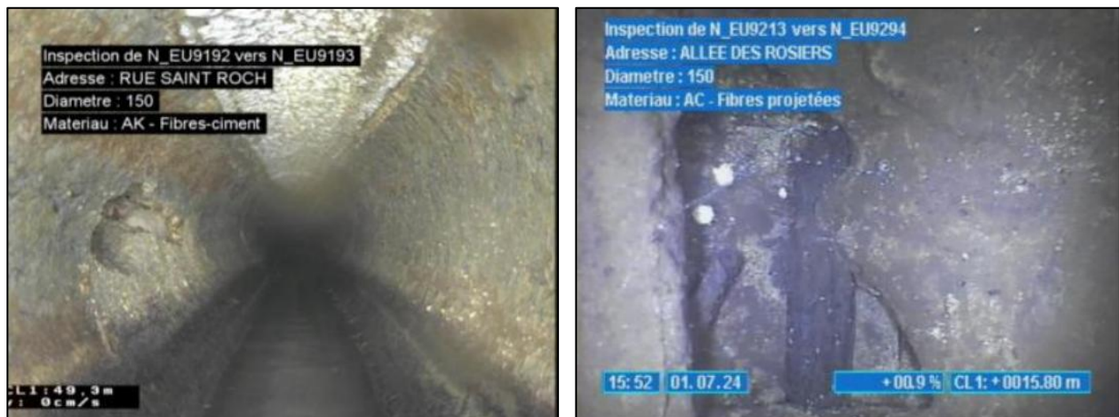
Figure 7 : Effondrement partiel sur les tronçons situés entre les regards N_EU9192 > N_EU9193 (à gauche) et sur les tronçons situés entre les regards N_EU9213 > N_EU9294 (à droite)
