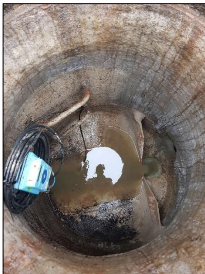
Photo 4 : Seuil et sonde piézométrique au niveau du regard N_EU8992
