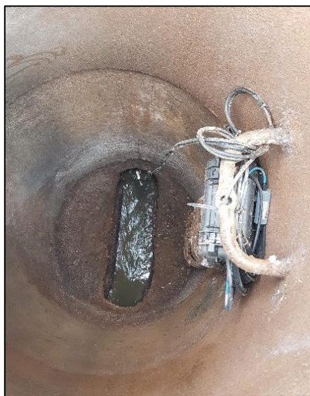
Photo 5 : Débitmètre Doppler au niveau du regard N_EU8706
