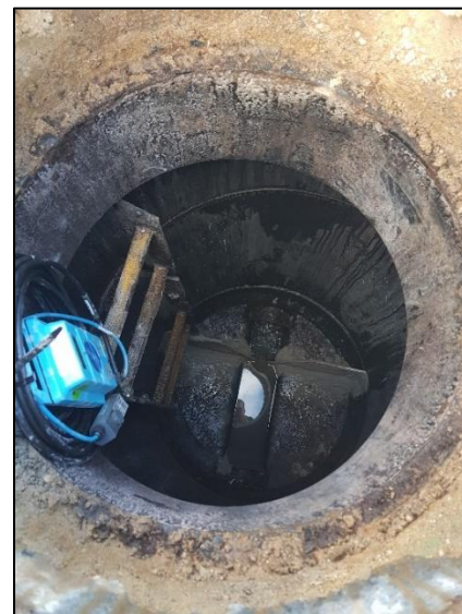
Photo 6 : Seuil et sonde piézométrique au niveau du regard N_EU8645
