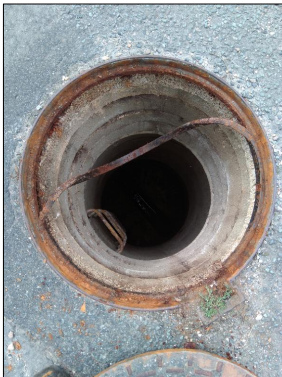
Photo 23 : Joint défaillant dans le regard N_EU9260
