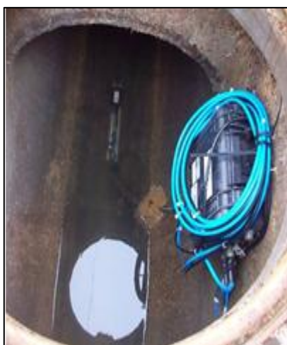
Photo 25 : Mise en place d'un débitmètre Mainstream et de sa mallette d'acquisition
