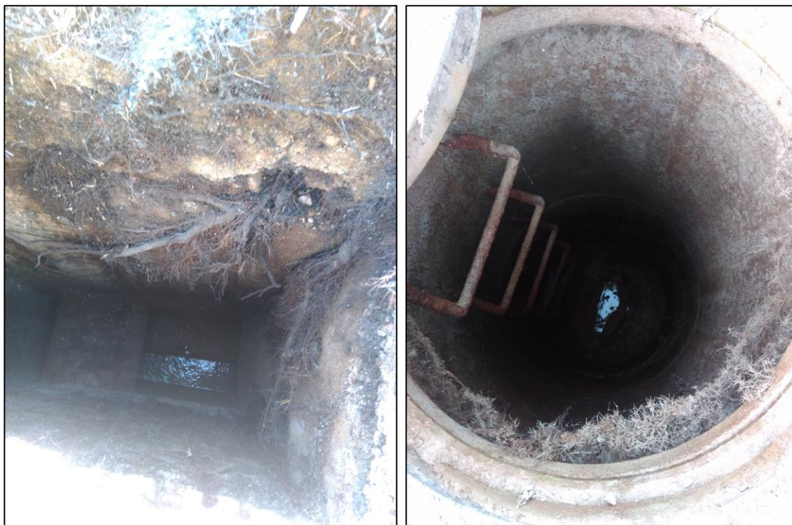
Photo 20 : Intrusion de racines dans les regards N_EU9155 et ASS_NOEUD 777
