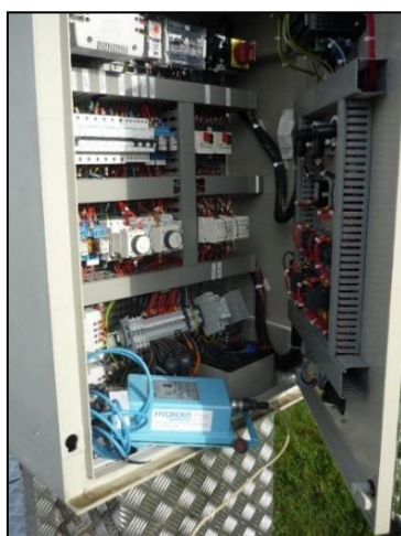
Photo 26 : Armoire électrique équipée de pincés ampérométriques
