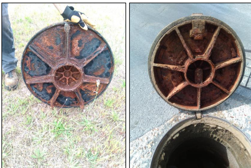
Photo 22 : Présence de corrosion sur les tampons des regards N_EU9255 et N_EU8751
