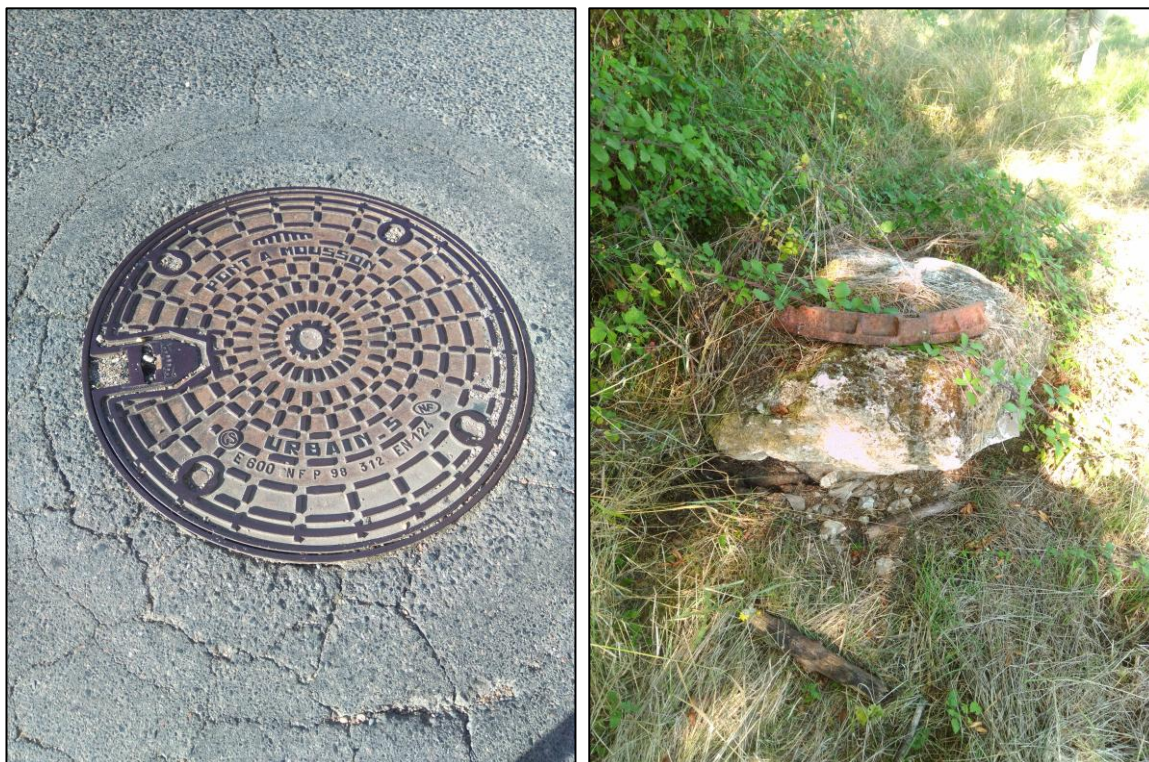
Photo 18 : Regards eaux usées N_EU8694 (boulonné) et ASS_NOEUD 753 non ouvrables
