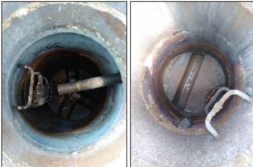
Photo 21 : Dégradation du génie civil dans les regards N_EU9255
