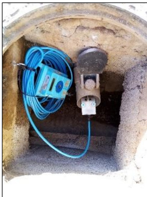
Photo 27 : Exemple de détecteur de surverse dans un trop-plein
