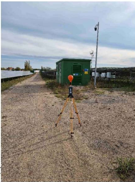
11.8 Point 8 à 10m du poste de Transformation
