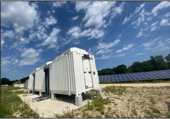
Figure 2 : Unité de stockage liée à la présence de panneaux photovoltaïques (Source : ZE Energy)
