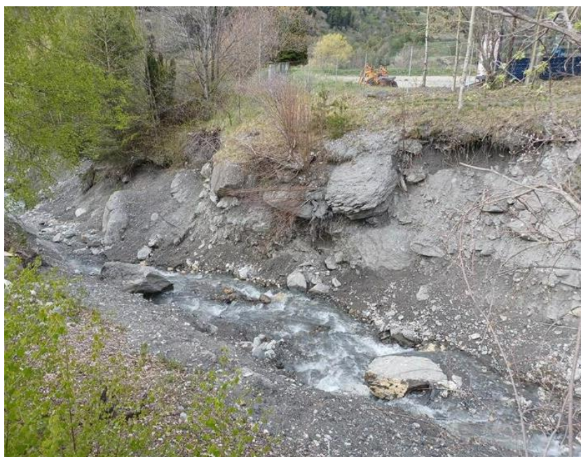
Figure 5 : berges instables entre le pont de la RD 1006 et la passerelle
