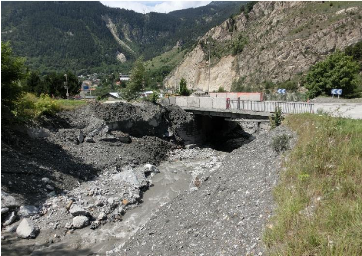
Figure 17 : Pont de la RD1006 après la crue de 2014
