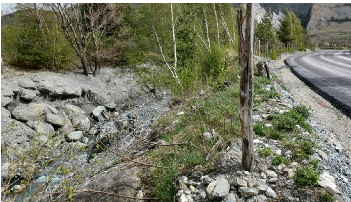
Figure 6 : Anse d'érosion en amont du pont de la RD1006, avril 2024
