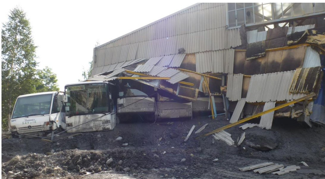
Figure 96 : Etat du chenal et du cône de déjection post crue 2014, P. Freydier pour INRAE
