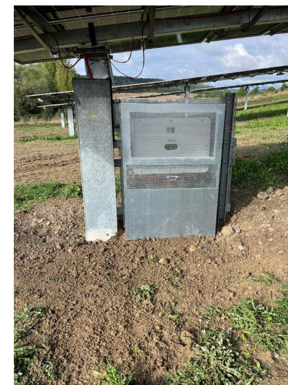
Figure 20: onduleurs string (source TSE)
